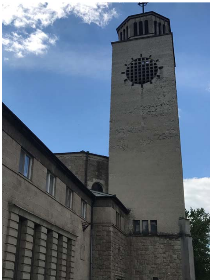
17. kép: pusztult kőporos vakolat
