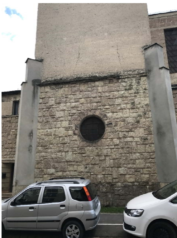
12. kép: kőporos vakolatot fedő cementes vakolat
