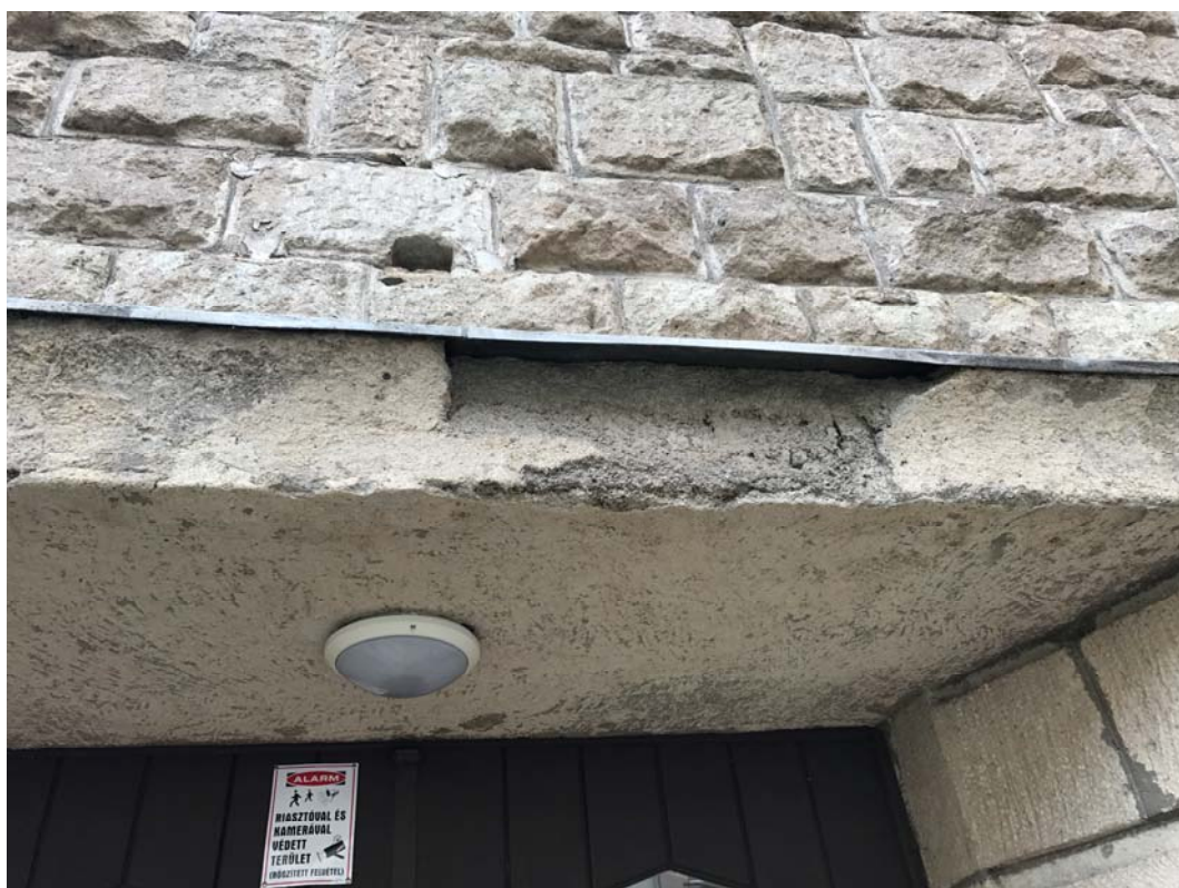
18. kép: pusztult kőporos vakolat
