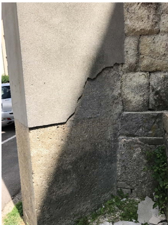
11. kép: kőporos vakolatot fedő cementes vakolat
